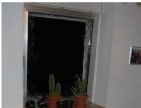
Durch die Druckwelle entstanden Risse in den Wänden, teilweise wurden Dachziegel abgedeckt und die Fenster barsten.
