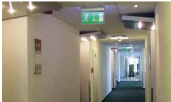
(12) Ordnungsgemäße Anordnung von Sicherheitsleuchten bei Kreuzungen im Gang und damit positiv auffällig (Hotel Mercure, Graz)
