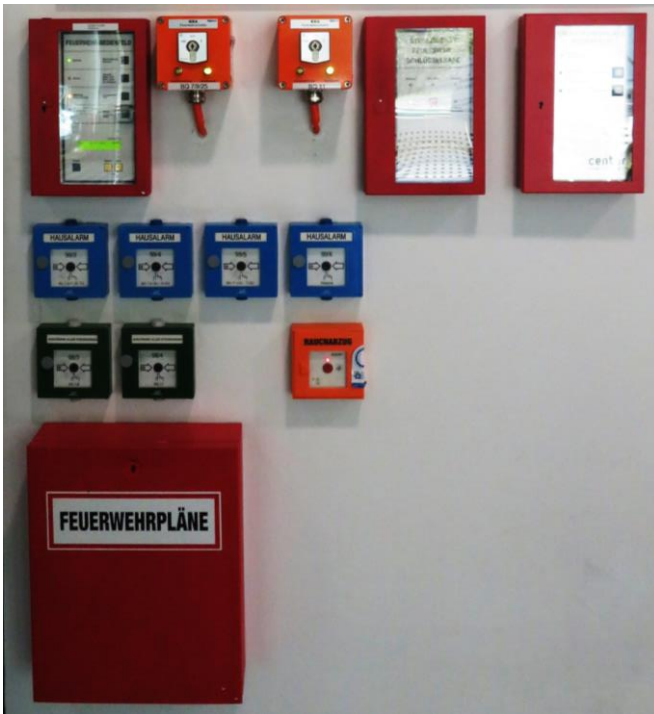
Bild 5 - Feuerwehrlankasten (gesichert mit Feuerwehrlankastenschloss - Untersperre des Feuerwehrlankastenschloss-Schlüssels nach Angabe der Feuerwehr - oder Druckknopf-melder-Schlüssel) an der Position des Hauptangriffspunkts der Feuerwehr (Feuerwehrbedienfeld FBF, Schaltkasten-Feuerwehrlankastenschlüssel, Bedienstellen Hausalarm)
